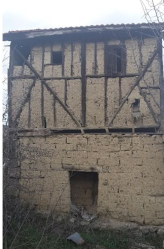
Fotoğraf 2 Tarık Aktekin Evi Güney. Helanın altındaki fosseptik bölümü ile abdestlikte kullanılmış suyu dışarı akıtan ahşap oluk. (Bölükbaşı Ertürk 2018)
