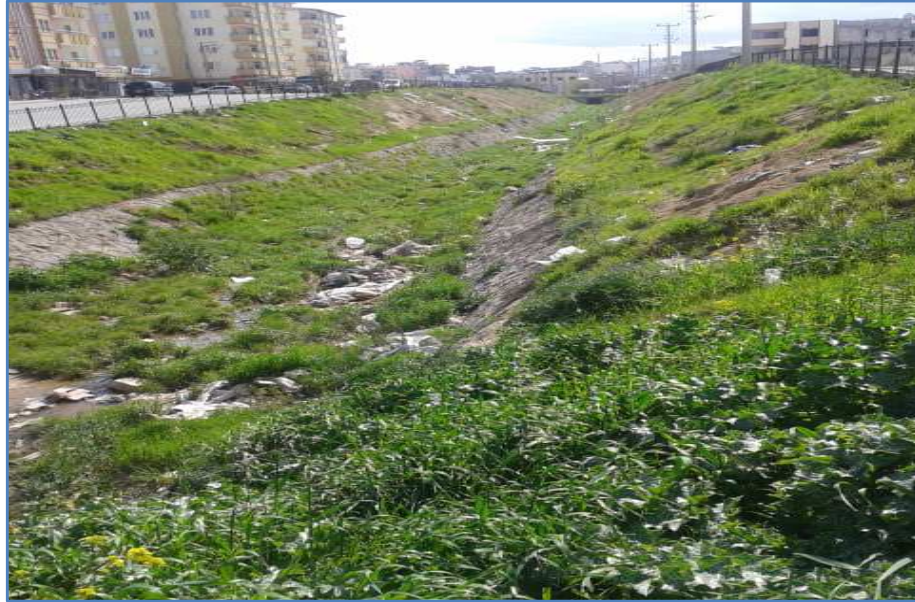
Foto 2: Yağmur suyu tahliye kanalı su baskınlarını önlemede yetersiz kalmakta, ayrıca katı ve sıvı atıklarla kirlenmektedir.
