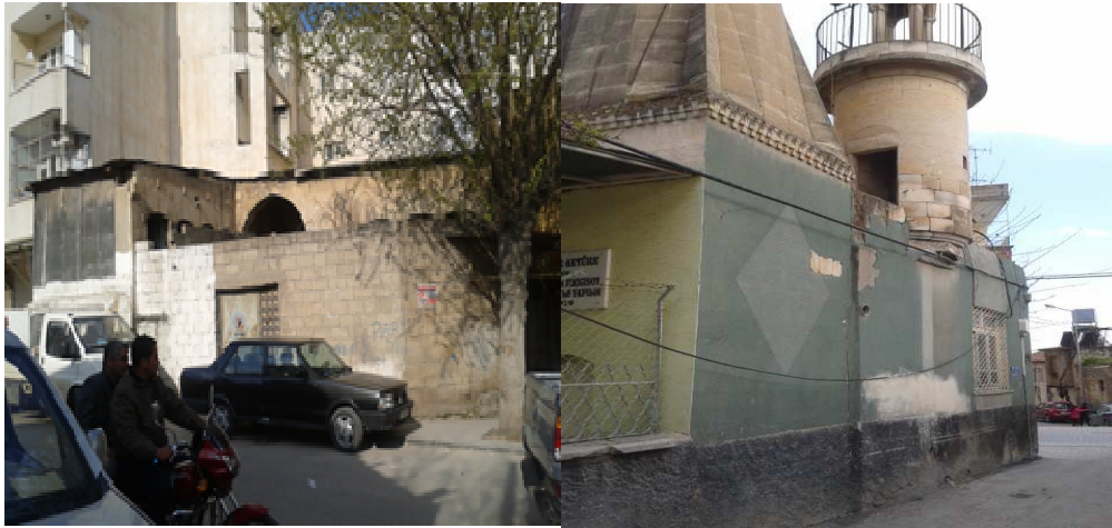
Foto 4: Eski Kilis Şehri'nde yer alan çok sayıda tarihi yapı hızla bozulmakta ve yer yer ortadan kalkmaktadır.
