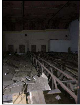
Şekil 14. Loca katındaki çelik makaslardaki nem, korozyon ve yalıtım eksikliğine bağlı bozulmalar
