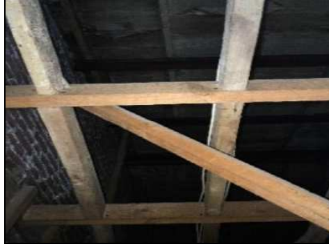
Şekil 19. Salon 1 üzerindeki ahşap çatı elemanlarındaki nem ve sehime bağlı oluşan bozulma
