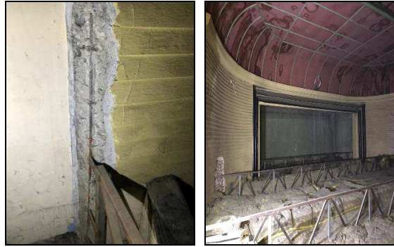
Şekil 17. Loca katında meydana gelen yüzey ve doku kaybı hasarları
