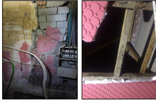
Şekil 31. Makine dairesi baca, duvar ve çatıda meydana gelen malzeme kaybı hasarları
