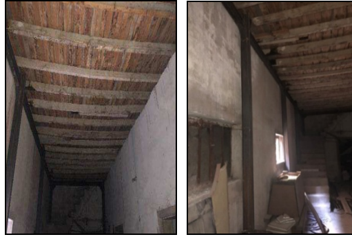
Şekil 29. Site sinemasında ahşap kirişlerde sehim hasarları
