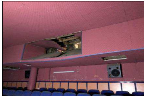
Şekil 15. Salon 1'in asma tavan kaplamasında ve ahşap kirişlerde oluşan bozulmalar
