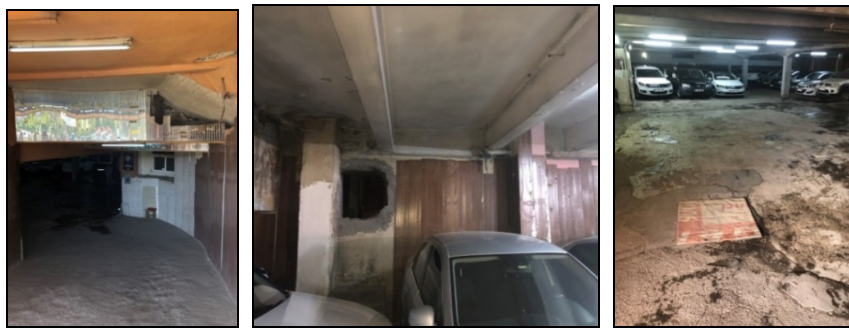
Şekil 32. Site Sineması otoparkında döşeme, kolon- kirişlerde oluşan malzeme kayıpları
