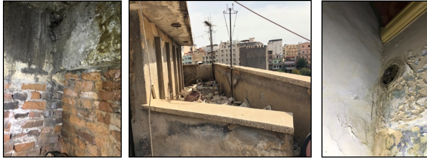
Şekil 36. Salon 6 makine dairesi ile çatıda neme bağlı oluşan bozulmalar
