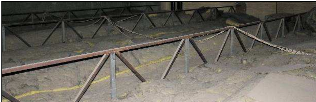
Şekil 21. Kapatılan loca katı döşemesinde oluşan bozulmalar
