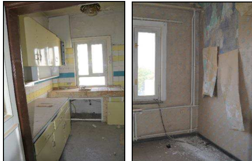
Şekil 24. Lojman ve misafirhanede neme bağlı oluşan bozulmalar
