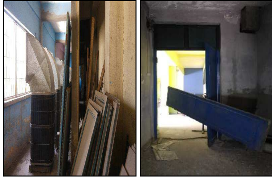
Şekil 20. Ahşap pencere ve kapılarda bakımsızlık ve kullanıcı etkisiyle oluşan bozulmalar
