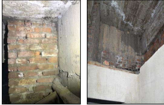
Şekil 25.Makine dairesinde neme bağlı oluşan bozulmalar
