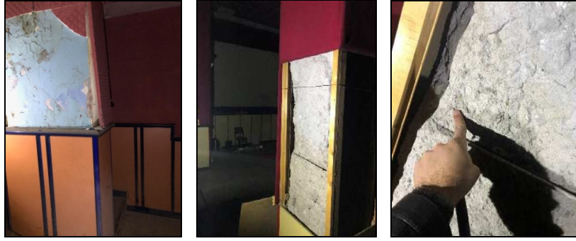
Şekil 13. Taşıyıcı Kolonlarda oluşan korozyon, sıva kaybı ve kesit daralmasına bağlı sorunlar
